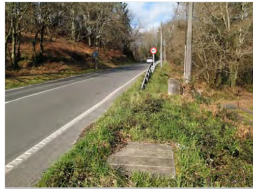
TELEFÓNICA - ARQUETAS AFECTADAS
