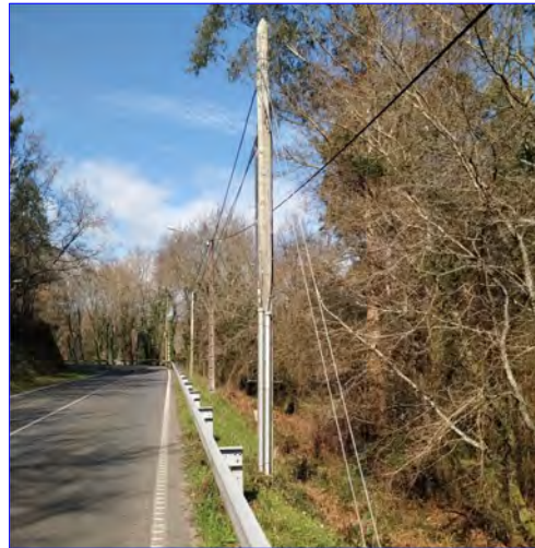
TELEFÓNICA - POSTES AFECTADOS
