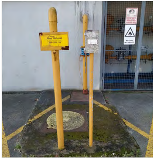
GAS - HITOS Y ARQUETAS NO AFECTADOS
