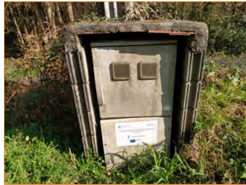
ELECTRICIDAD / ALUMBRADO CONTADOR / CUADRO ELÉC. AFECTADO
